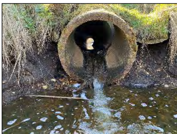
Foto 5, set mod syd. Ved rørudløb ved Frølundvej er der en faunaspærring.
